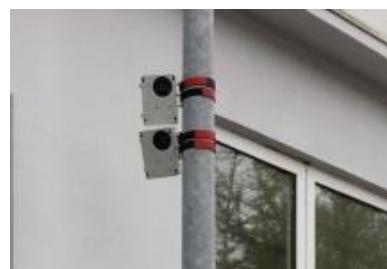
Zählkamera am Lampenmast
